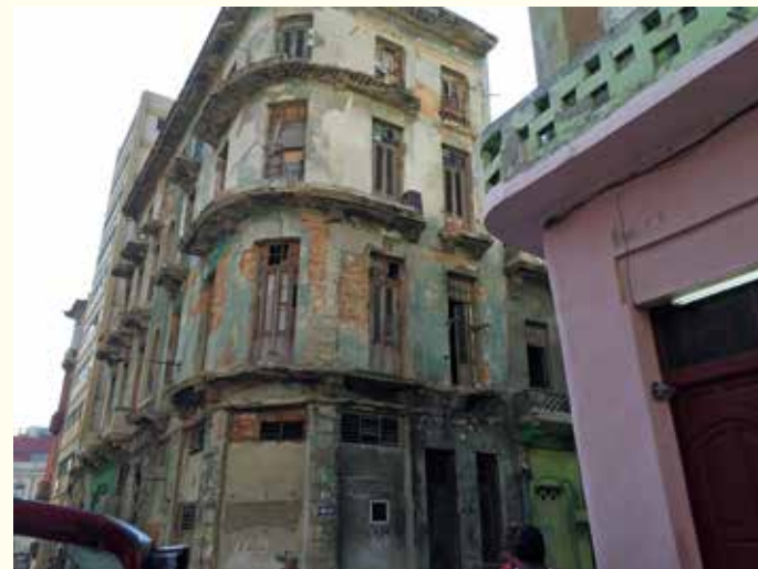
多くの住民が住むオールドハバナにある歴史的建築物。外壁が腐食しバルコニーが落下している。この状態でもこの建物には人住んでいる
