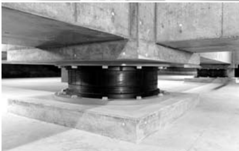
免震装置(積層ゴム支承)
