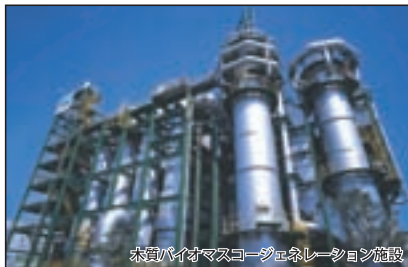
木質バイオマスコージェネレーション施設
