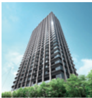
● ザ 湾岸タワー レックスガーデン(施工中) 施工 / 正友地所(株) 施工 / 前田建設工業(株) 内装工事 / 当社
