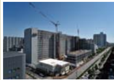
● 検見川浜レジデンス(施工中) 施主 / 野村不動産(株) 施工 / 前田建設工業(株) 内装工事 / 当社
